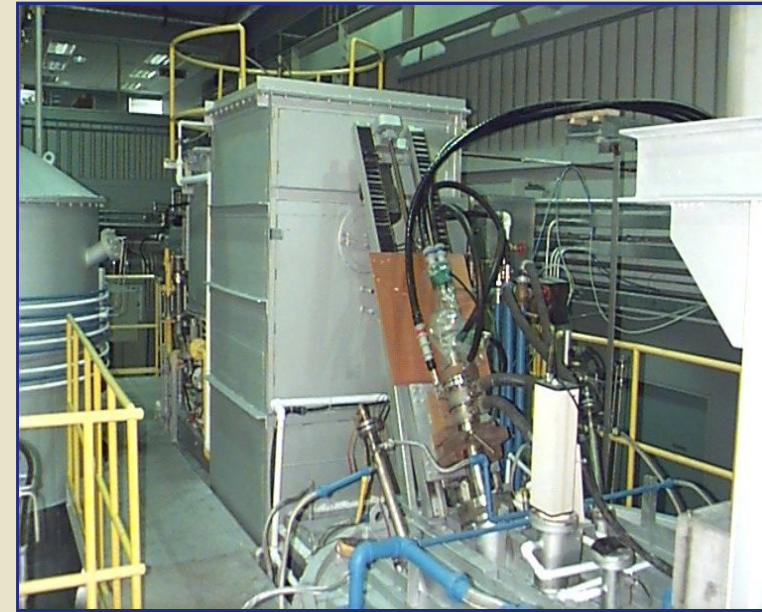
Плазмотермическая установка для плавления мелкодисперсных отходов мощностью 1 МВт
